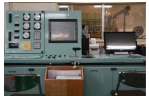
コントロールルーム
