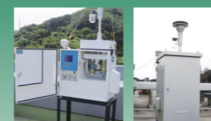
(a)成分分析用の測定器 (b)連続測定用測定器 本校屋上に設置された測定器
