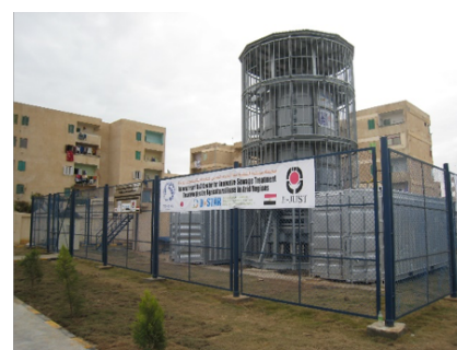
エジプトで実験を行った省エネ型下水処理装置
