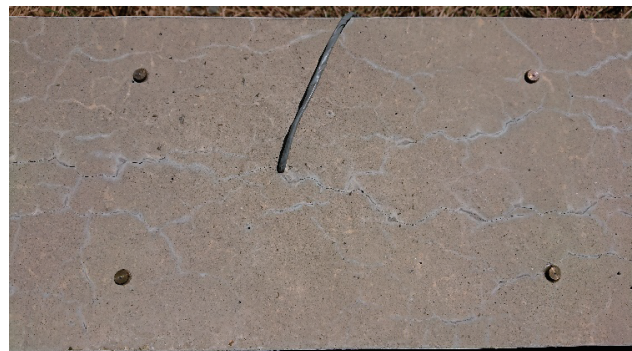
ASR による膨張ひび割れ
