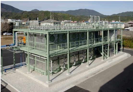
須崎市終末処理場に建設された DHS 下水処理システムの外観
