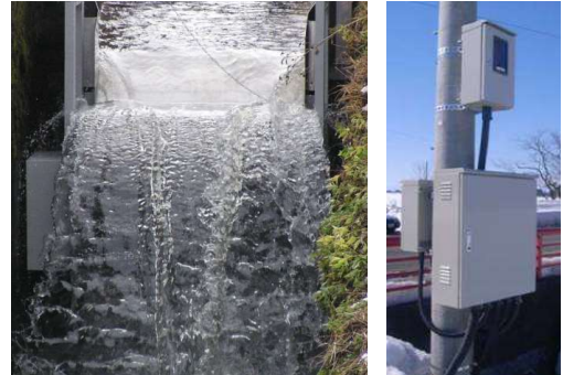
図3 落差工に設置したマイクロ水車と系統連系用機器
